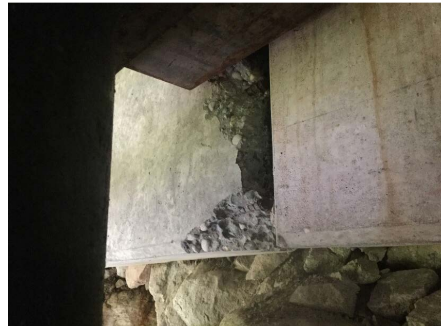
DS ballast wall damage
